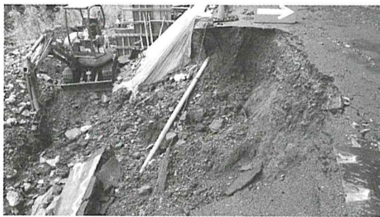
写真B 松野血流量水ノ口橋上流右岸農業用水路が埋まり
